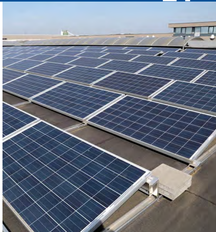
Quelque 2 000 panneaux photovoltaïques ont été placés sur les toits qui évitent le rejet annuel de 340 tonnes de CO 2
